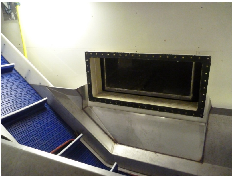
Bilde 2-9; Utløp av buffertank til fabrikk, under ombygging. Foto: SINTEF Fiskeri og havbruk AS
